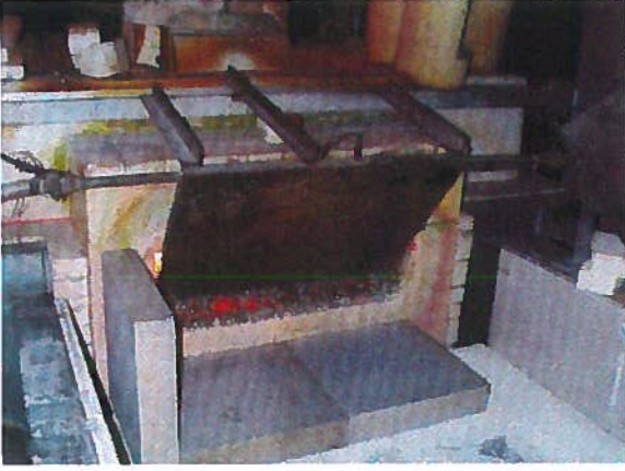
Çalışma havuzu ile forehearth arasına yerleştirilen su ceketi
